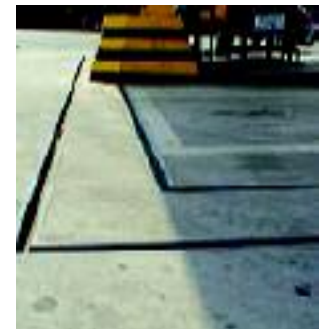
FIGURA 7 - Canaleta de by pass da água pluvial
